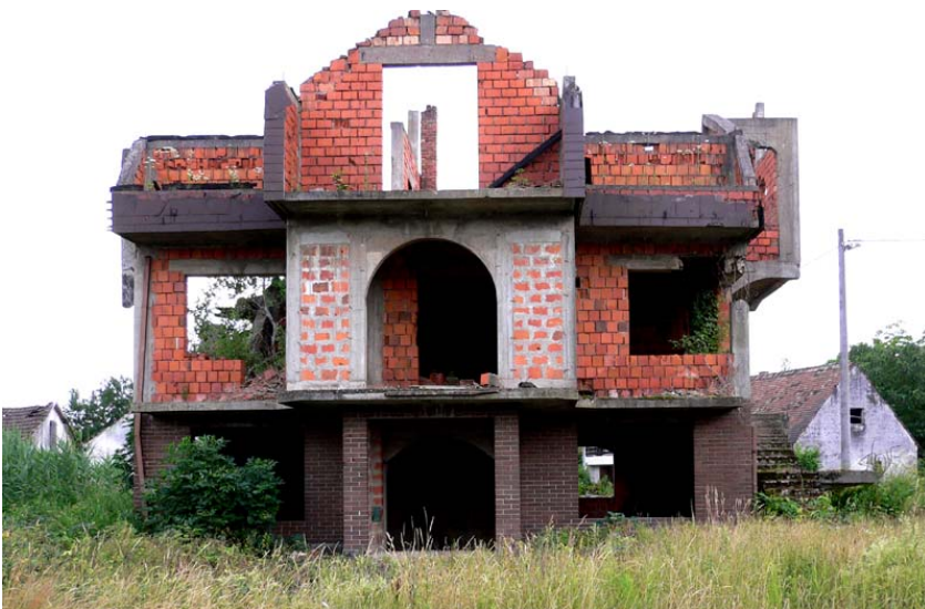
Et hus der måske er under renovation??? Men det har stået på længe, fordi der vokser træer inde i huset. Eller også er det bare blevet forladt...
